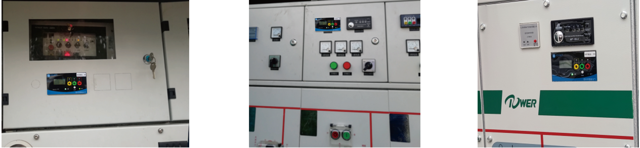
EPD-500现场安装实例
